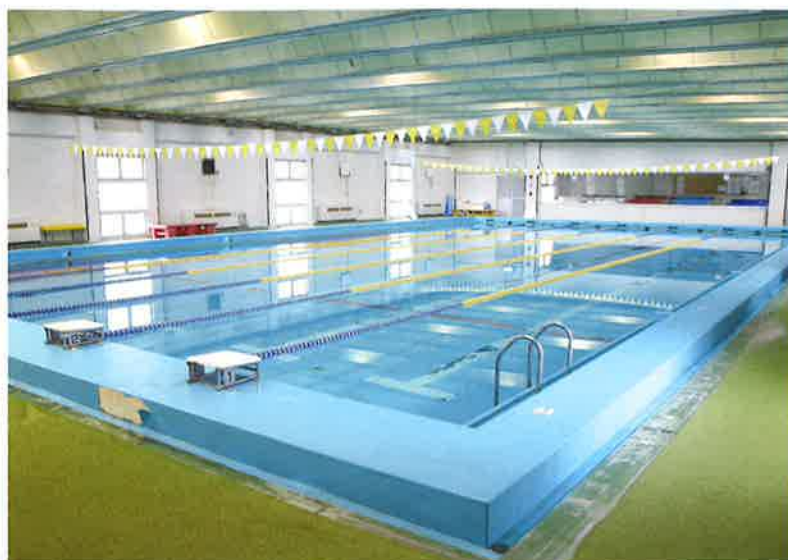
古くなった室内温水プールは年中利用されているため塩素剤などによる劣化がみられる。
