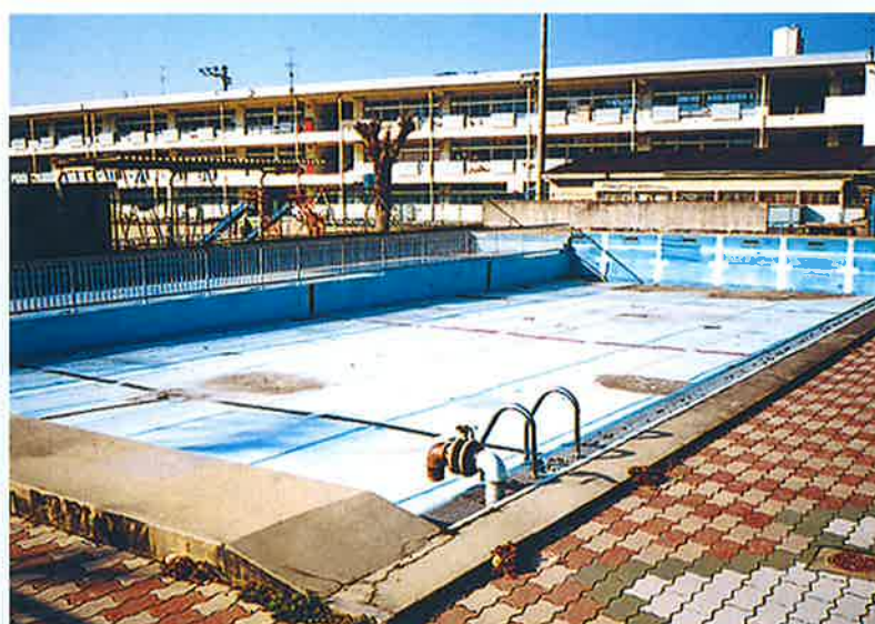
寒暖の差が激しい屋外プールは本体だけでなくプールまわりの老朽化が早い。
